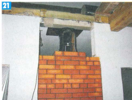
21 Сэндвич-дымоход опирается на кирпичный щиток.
